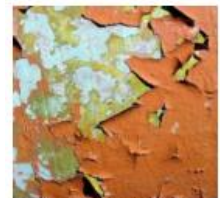
Pintura con plomo descascarada
